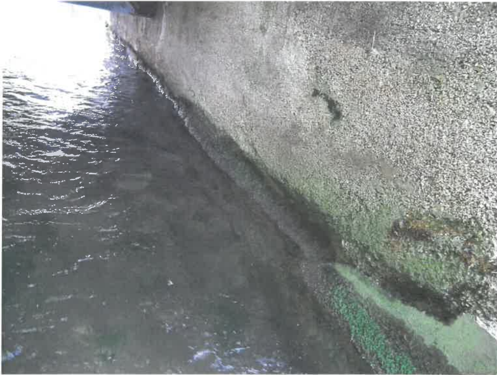
Foto 5 westliches Widerlager, beginnende Unterspülung
