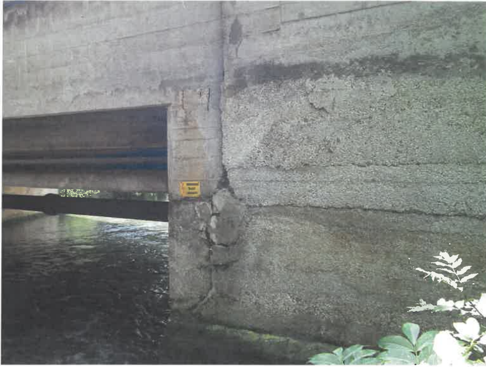
Foto 7 Betonausbruch Widerlager West, Nordseite
