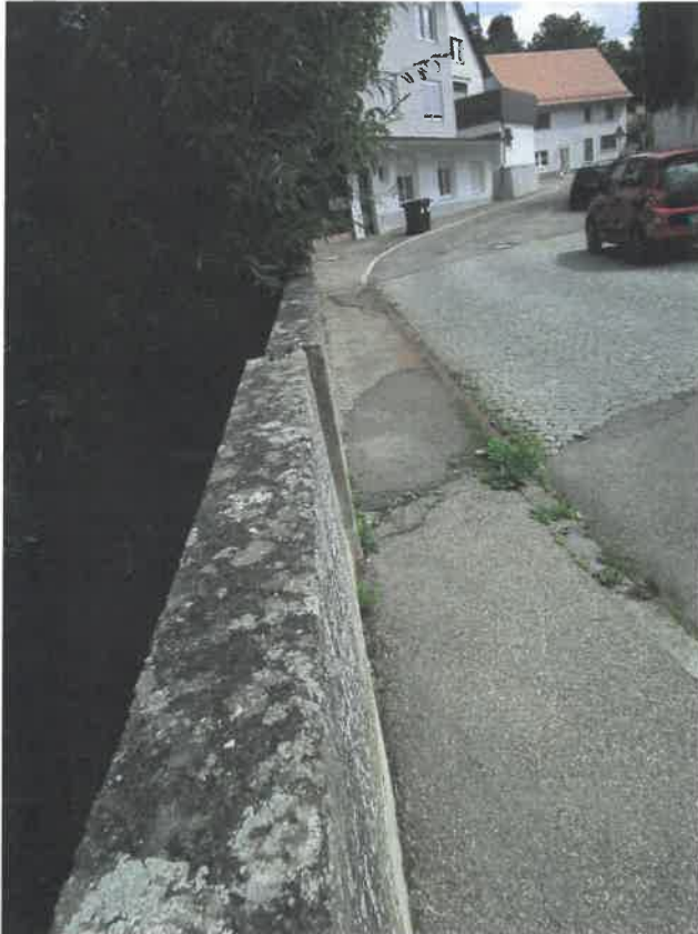
Foto 9 Brüstungsmauer Nord, Verschiebung der Flügelmauer
