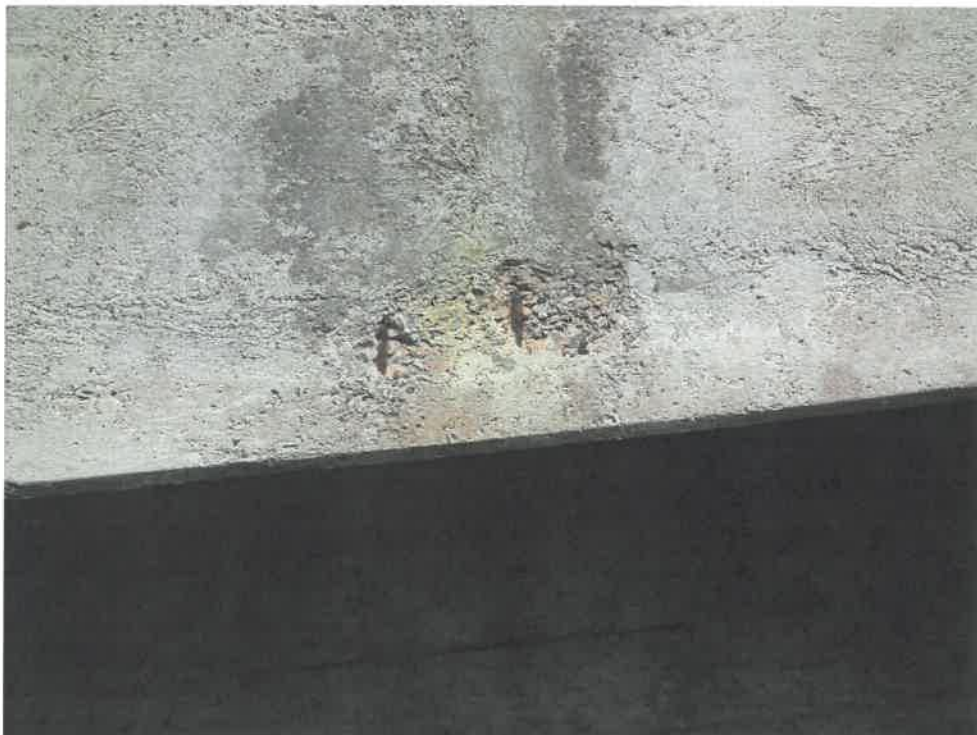
Foto 8 nördliche Brüstungsmauer, Betonausbruch mit freiliegender Bewehrung
